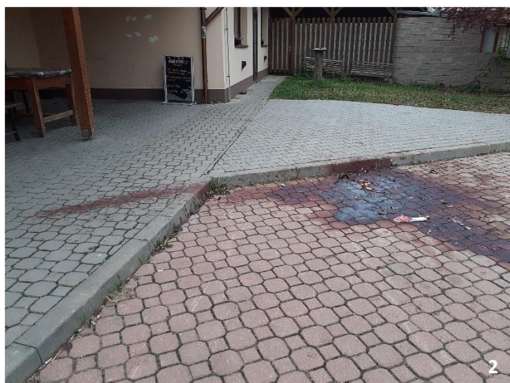
Obr. 2 Zbytky neznámé kapaliny po odvozu velkoobjemového odpadu. Zlikvidováno a očištěno na náklady obce.
